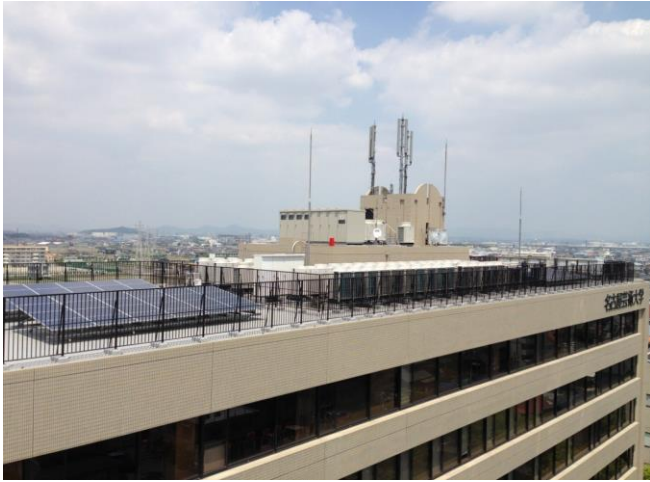
※5 平成23年度 東1号館屋上太陽光発電設備設置(20kw)
