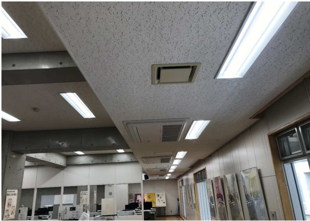
※1 平成31年度 西キャンパス X棟高効率空調機更新(人感センサー付)
